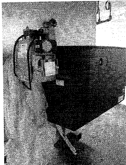
Figura 8: Queimador da caldeira
