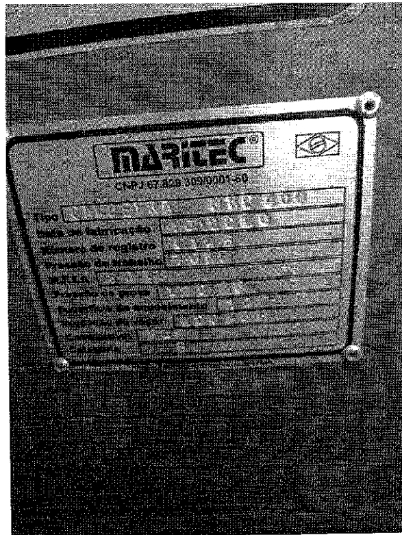
Figura 5: Placa da Caldeira
