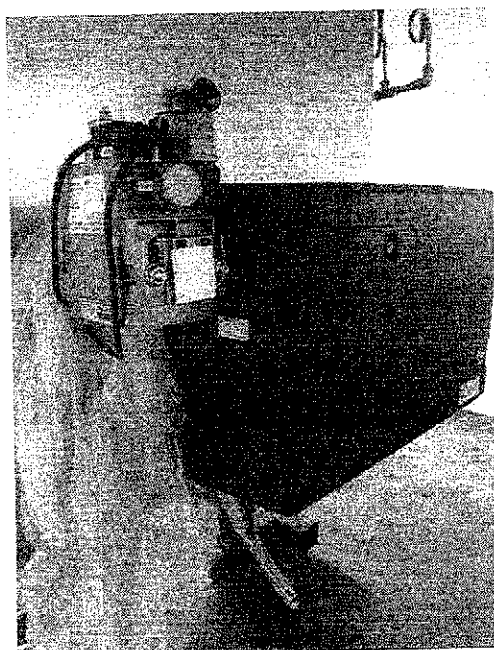
Figura 8: Queimador da caldeira
